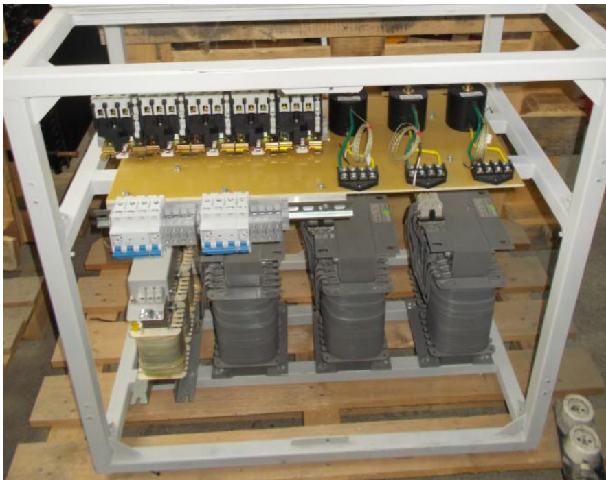
Fig.4.4. Vedere componente de forță: filtru sinusoidal, transformatoare de injecție, contactoare
